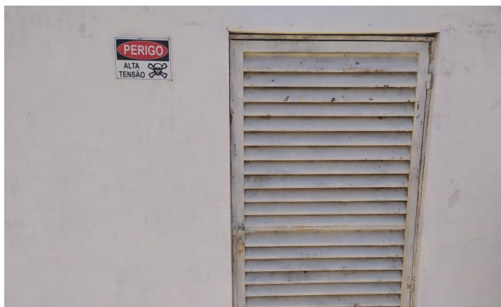
Fotografia 30 - Acesso trancado à torre de energia
