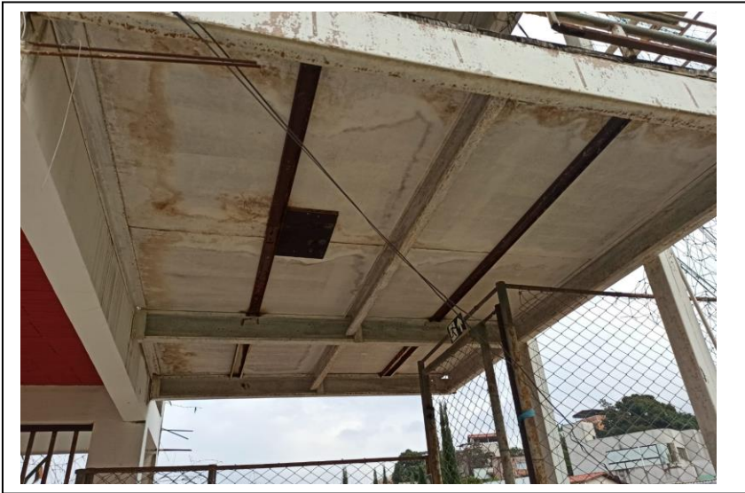
Foto 47 – Madeirites do piso comprometidos
