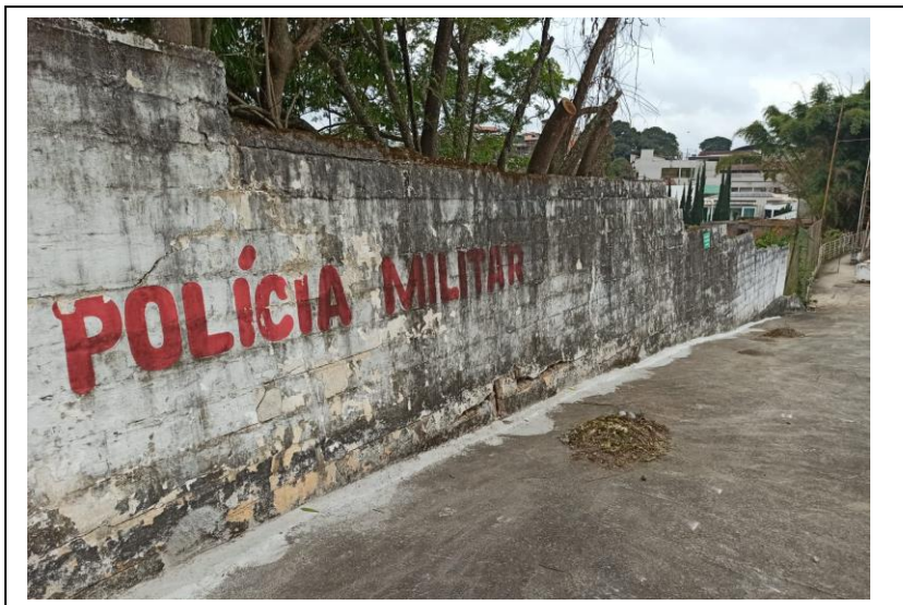
Foto 50- Muro com estrutura comprometida
