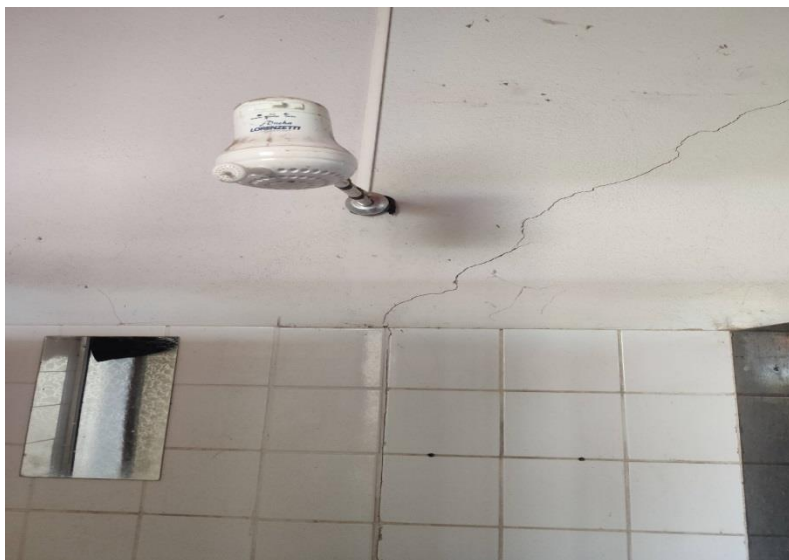
Foto 37- Trincas banheiro prédio cabines radio/tv
