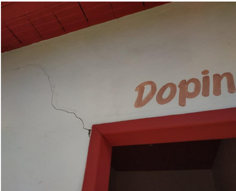
Foto 36- Trinca parede prédio Cabines de Rádio/TV
