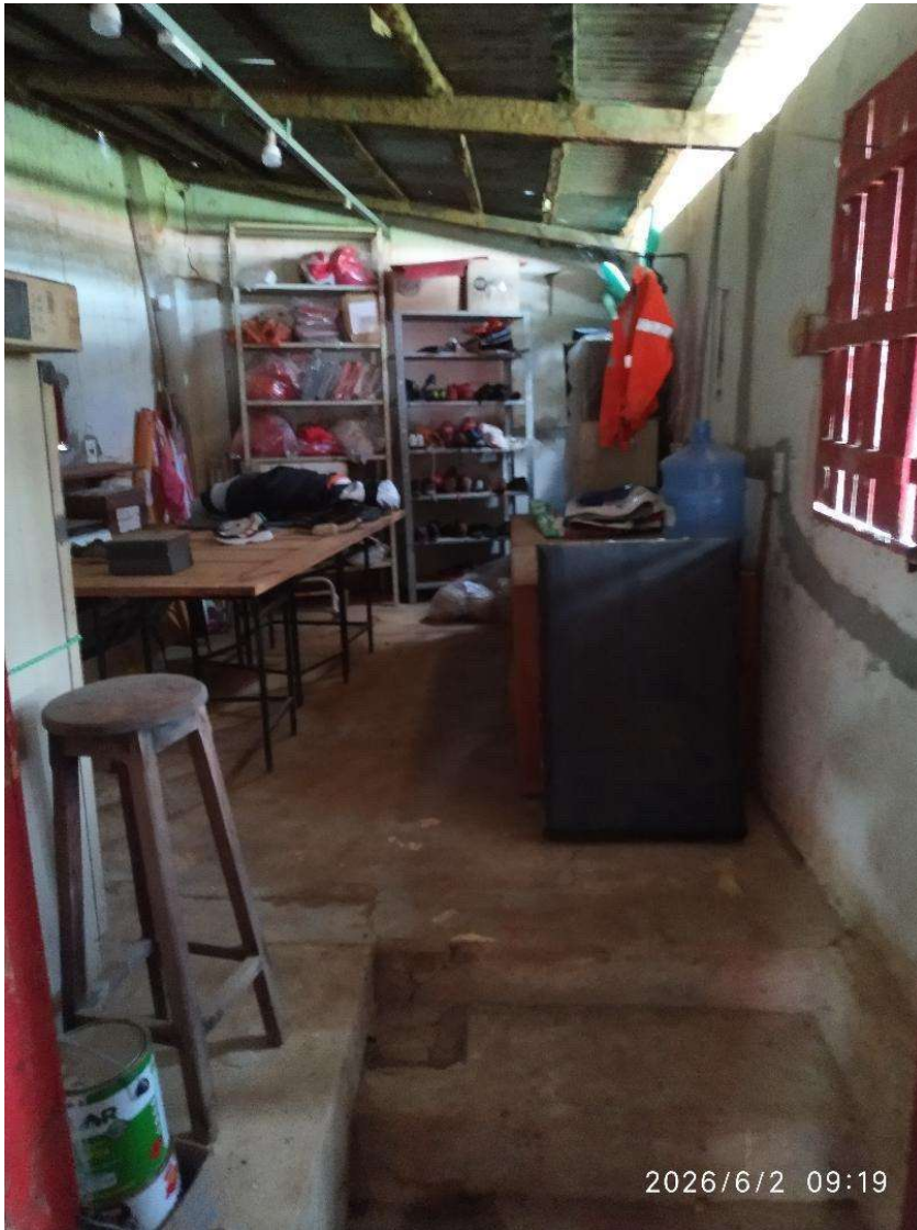
Sala da PM e de custódia em reforma para troca do telhado e fazer divisórias para atendimentos.
