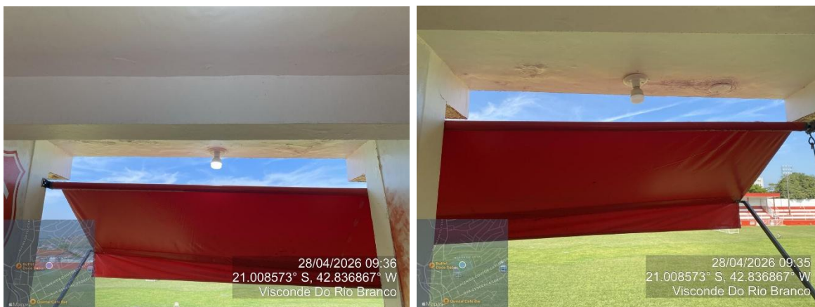
Figura 9 - Anomalia no revestimento
