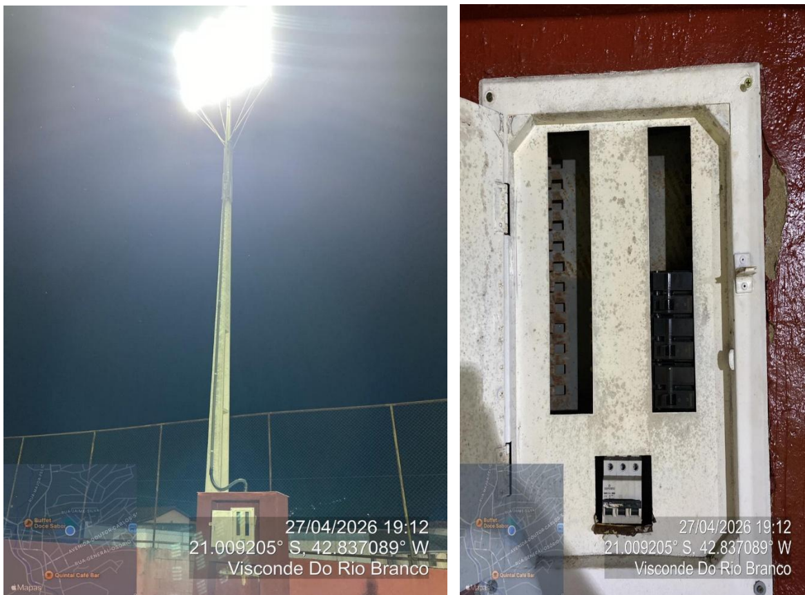
Figura 15 - Quadro Elétrico de Acionamento
