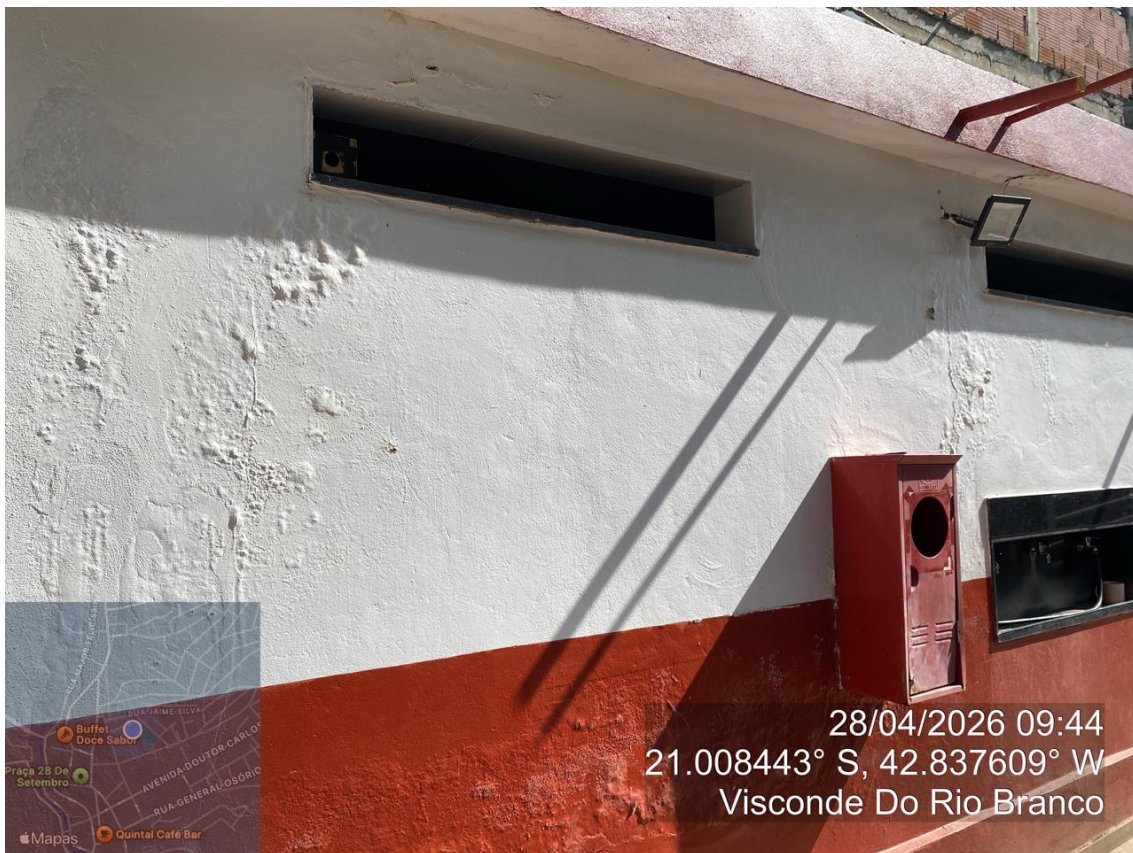
Figura 8 - Anomalia na parede externa dos banheiros sociais
