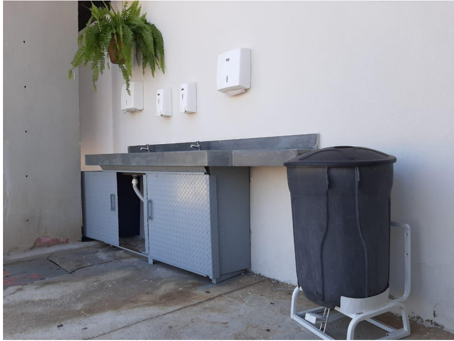
FOTO 05 – LAVATÓRIO ENTRADA PRINCIPAL
