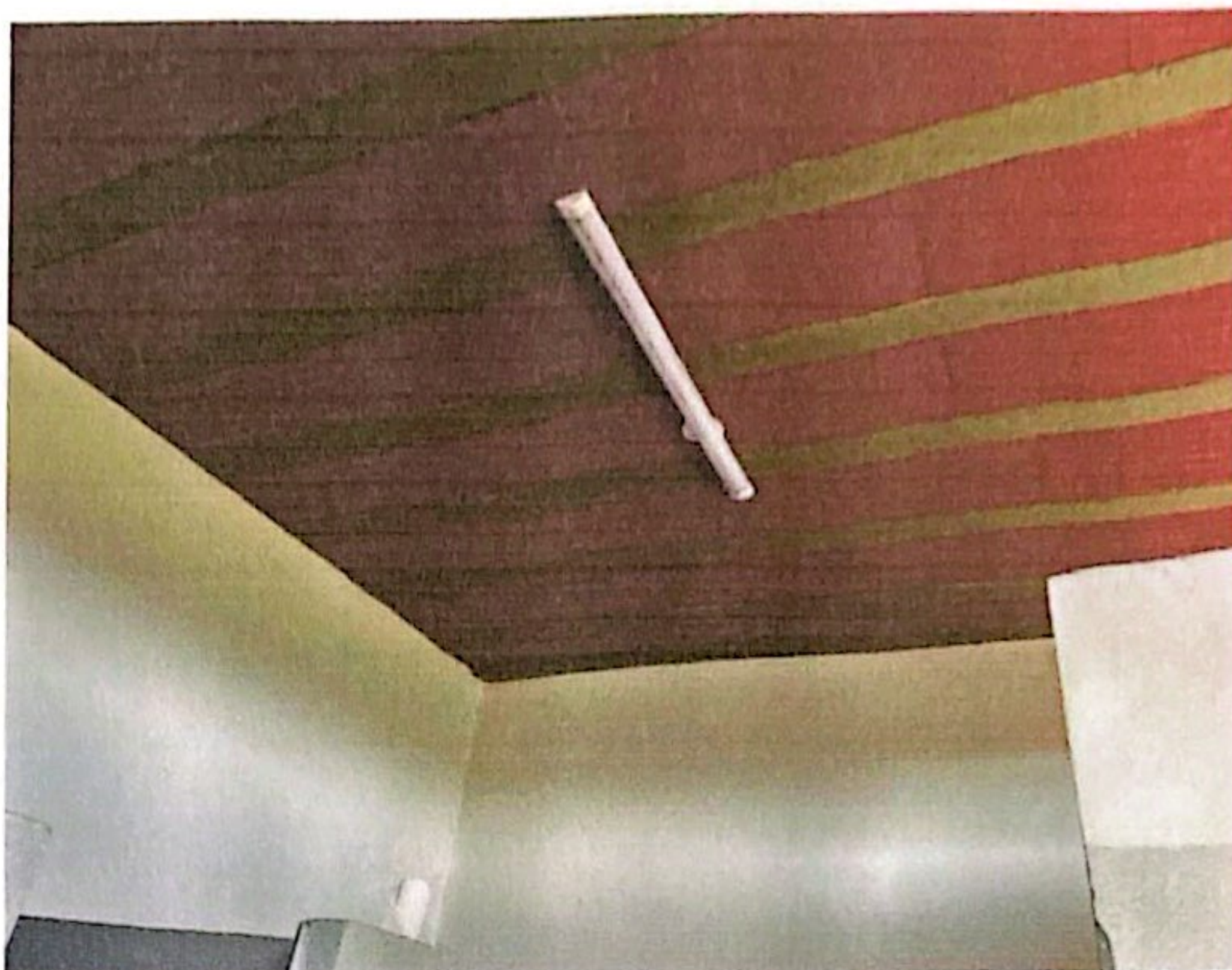
FOTO: Sistema de forro, esquadrias e iluminação do bloco de sanitários e bar para torcedores da agremiação visitante.
